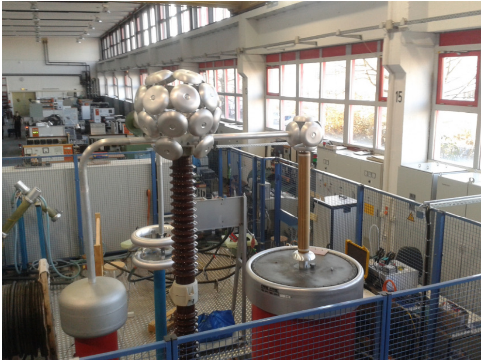
Wechselspannungs-Prüfsystem zur Erzeugung von Wechselspannungen bis 200 kV
